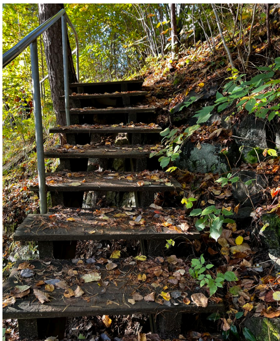
Figur 2-10 Hvor lenge denne trappa holder er usikkert, men den er relativt ustabil. Det er også verdt å merke seg at det er nokså bratt ned skrenten til venstre for trappa. Foto: Markus Strand.
